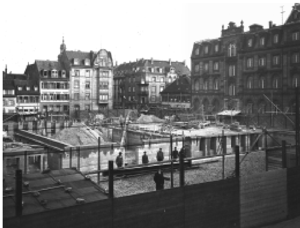
Fundament und Kellergeschoss des Rathausneubaus, um 1937; rechts im Bild das Börsengebäude in E 4.
