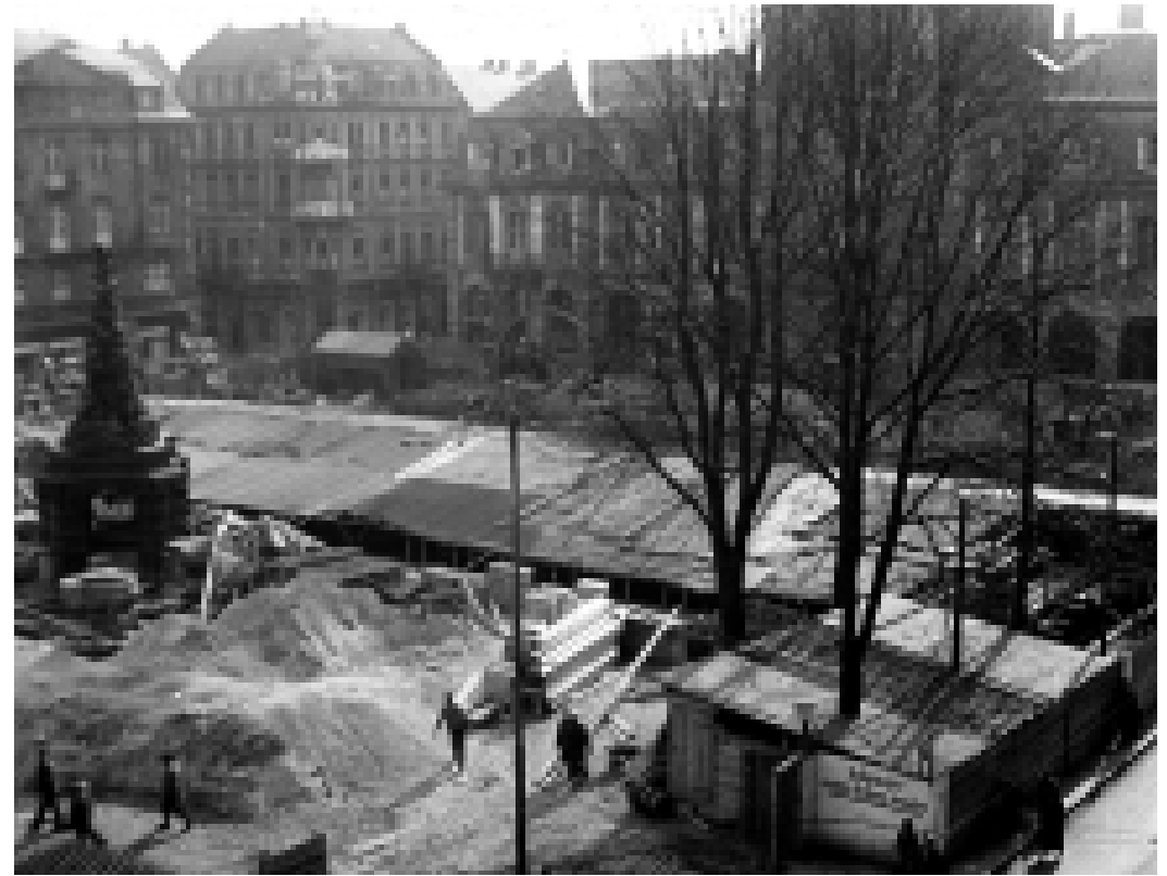
Paradeplatzbunker im Bau, März 1941. Der Bunker wird bereits im Sommer 1941 provisorisch genutzt und im April 1942 offiziell übergeben.
