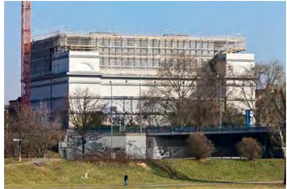
↑ Nach dem symbolischen ersten Hammerschlag am 7.3.2016 wird mit der Aufstockung des Bunkers begonnen. Foto vom Februar 2017.
